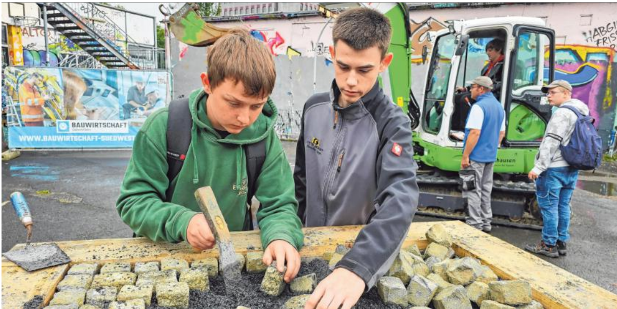
Benedikt Hayn (r.) ist Azubi bei der Firma Quast und zeigt Neuntklässler Henry Konrad die Technik beim Naturstein-Verlegen. Fotos: Anja Bieler-Barth
