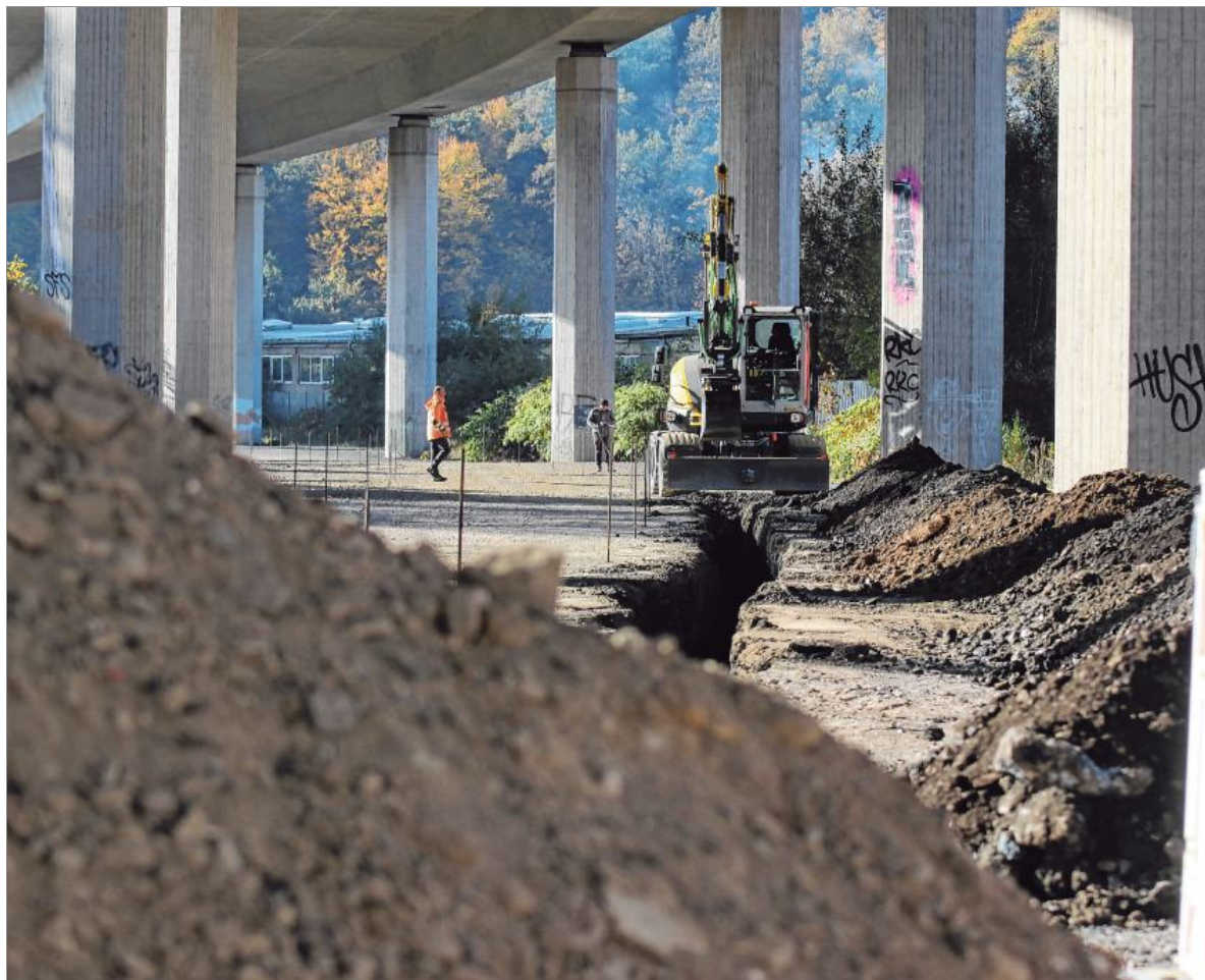
Der Radwegbau an der Schemscheid hat begonnen. Als Erstes wird ein Graben ausgehoben, in dem Stromkabel verlegt werden. Die werden für die Beleuchtung benötigt.
